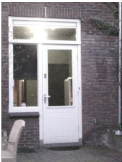
FLIR0809.jpg FLIR E53 84504498
