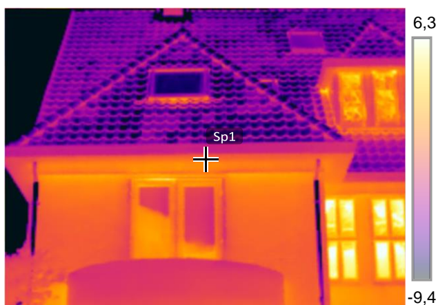
FLIR0794.jpg FLIR E53 84504498
